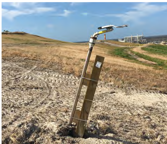
Figura 16. Tubos de subida não devem ser instalados perpendicularmente a inclinação da área. O aspersor nesta foto terá irrigação irregular e pode travar sem o uso de um kit contrapeso.
