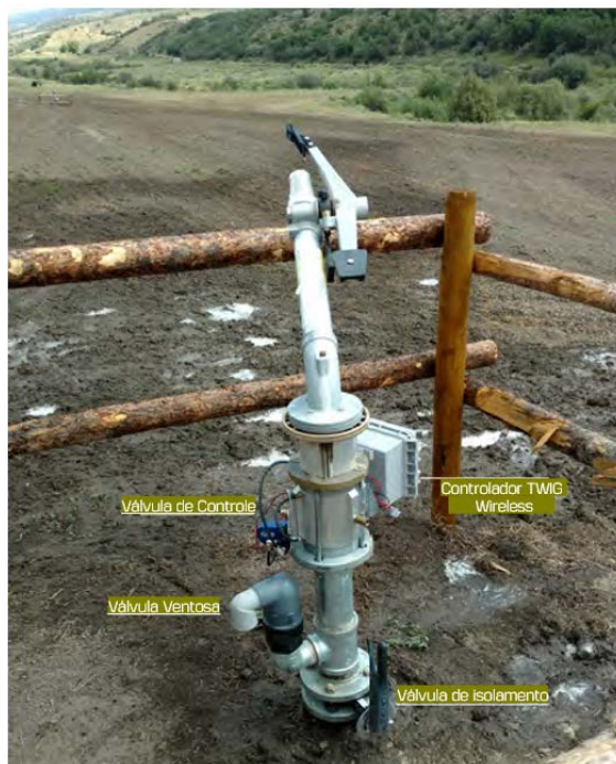
Figura 18. Aspersor F150 Big Gun® com válvula de controle Nelson Série 800 e controles sem fio TWIG®, instalado em um tubo de subida com válvula borboleta para isolamento, e válvula de alívio de ar de ação contínua Nelson ACV200.
